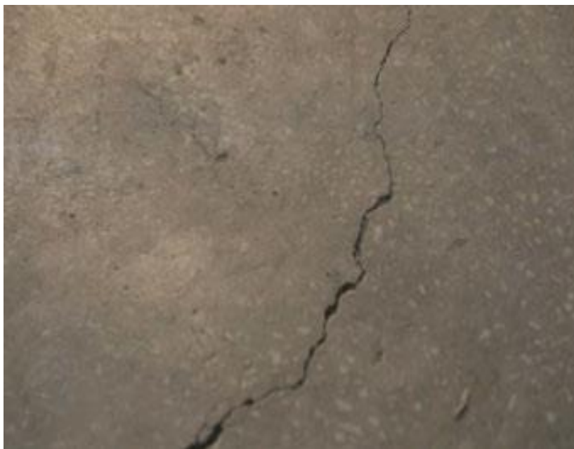
Рисунок 1 – Подвижная трещина. Общий вид
